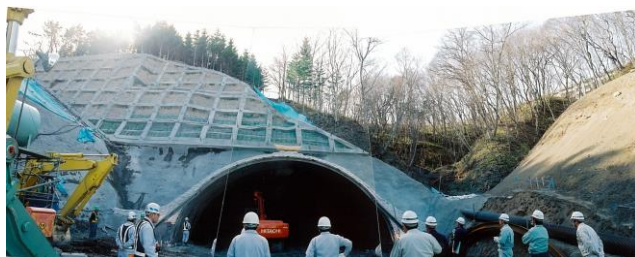
図7 変状を起こしたトンネル坑口
